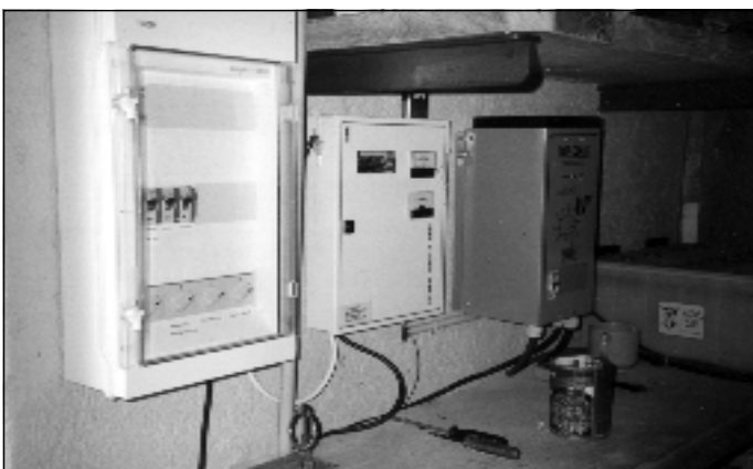
Oben die Steuerungsanlage mit dem Wechselrichter, der den Gleichstrom in Wechselstrom umgewandelt.
